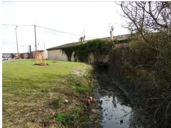
Ruisseau de Terre Blanche en sortie de la buse passant sous le bâtiment
