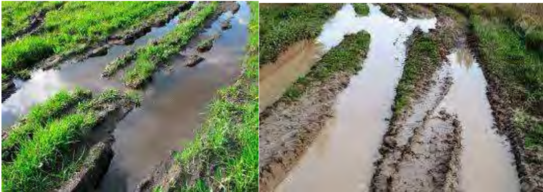
Figure 174 : Exemples d'ornières de chantier
